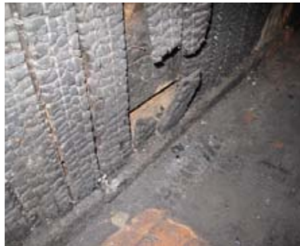
Фото 6. Вид нижней части межоконного простенка жилой комнаты. Доски обшивки простенка рядом с полом обуглились на всю толщину (20 мм), плинтус на глубину 16 - 19 мм
