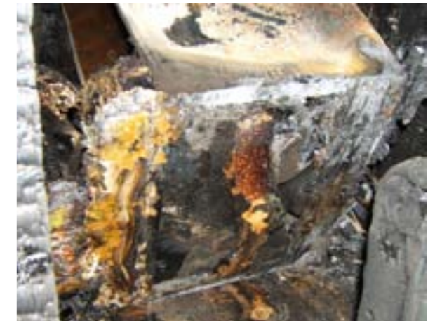
Фото 27. Вид днища поврежденного пожаром морозильника, опрокинутого на боковую (левую) сторону. Дно холодильника, выполненное из легкогоряемых материалов, не выгорело, просматривается внешний пластиковый слой (1) сотовой структуры (видны характерные полосы) и слой ППУ над ним (2). Корпус мотор-компрессора (3) закопчен. На поверхности пола налипли тонким слоем расплавленные полимерные материалы, прогар в полу отсутствует
