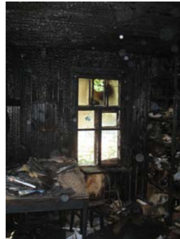
Фото 7. Вид части жилой комнаты в районе окна в стене, расположенной напротив стены с дверью, ведущей в прихожую. Поврежден только фрагмент остекления (1) в верхней части окна
