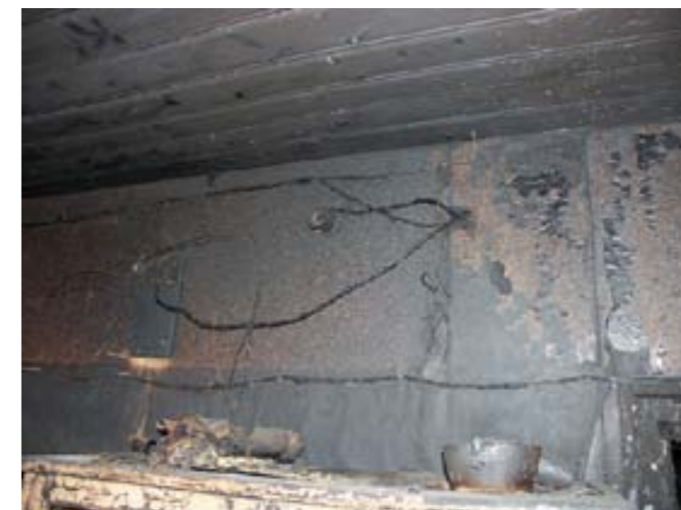
Фото 3. Вид части прихожей выше уровня буфета (1). Обои выгорели выше косяка (2) двери, ведущей в жилую комнату. Потолок (3) потемнел, но не обуглился. Изоляция электропроводов обгорела. Электропроводка выполнена одножильными (4) и двухжильными (5) проводами
