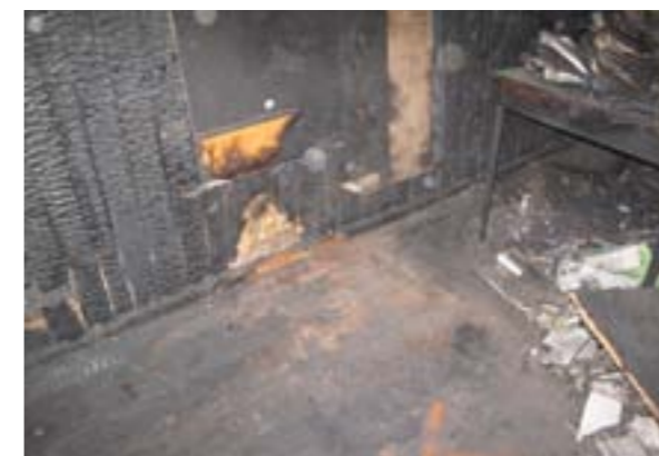
Фото 15. Вид очищенного от пожарного мусора участка пола, части межоконного простенка (1), забитого панелями (2) от шкафа правого окна и стола (3) с обгоревшими книгами. Повреждения уменьшаются в направлениях от низа межоконного простенка. На обшивке стены под окном заметно светлое пятно (4) – след от прислоненного мешка картошки, располагавшегося здесь перед пожаром
