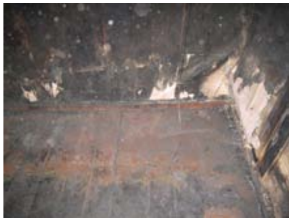
Фото 9. Вид нижней части помещения жилой комнаты возле угла, образованного стеной (1) с дверным проемом и стеной (2) с двумя оконными проемами. Участок пола (3) под шкафом пожаром практически не поврежден. Доски обшивки стены (4) в нижней части и плинтус (5) практически не повреждены
