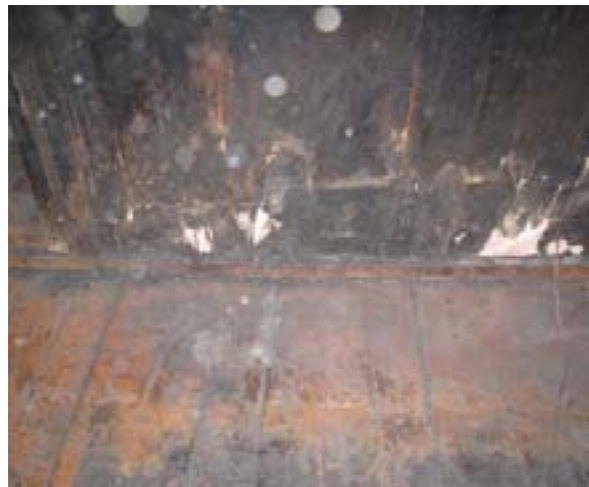
Фото 5. Вид части жилой комнаты справа от дверного проема (1). Обугливание наличника двери наблюдается выше уровня 30 - 40 см от пола. Доски пола (2) рядом с дверным проемом и вдоль стены, где располагался трехстворчатый шкаф, а также плинтус (3) практически не повреждены
