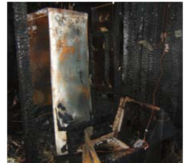
Фото 23. Вид части поврежденной пожаром жилой комнаты возле межоконного простенка. Комбинированный провод от лежащего на подлокотнике кресла УЗО до щитка с электросчетчиком, составленный из короткого фрагмента многопроволочного проводника (1) и фрагмента однопроволочной жилы (2), имеет длину более 1,5 м
