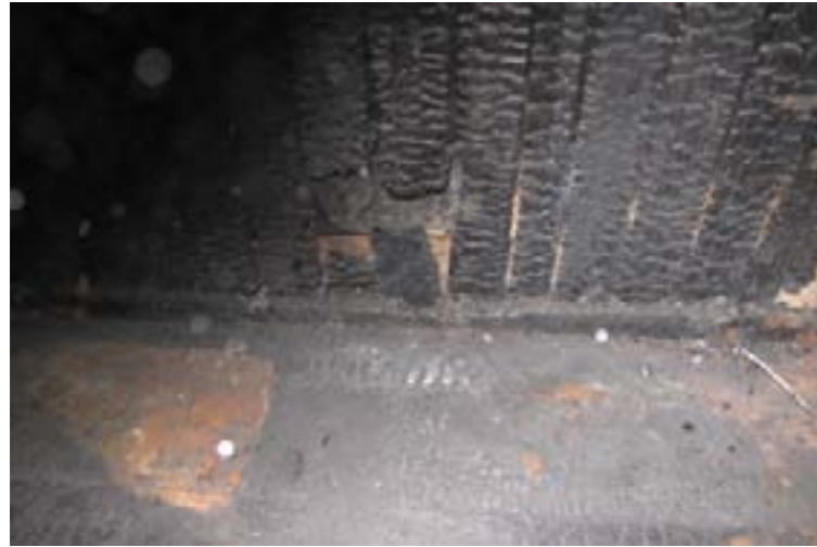
Фото 20. Вид нижней части межоконного простенка, где доски обуглены на всю толщину с образованием плотного угля без глубоких поперечных трещин (1)
