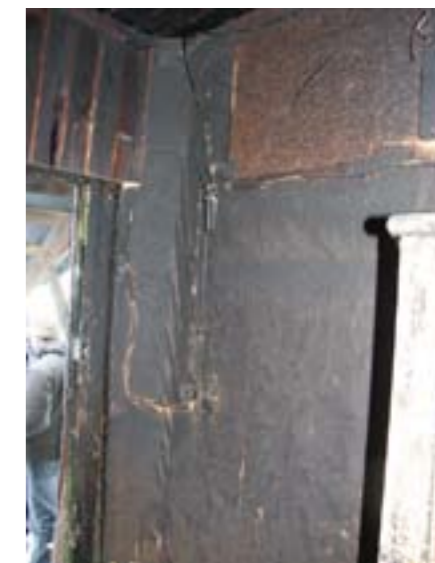
Фото 4. Вид участка стены прихожей между буфетом (1) и входной дверью (2). Обои на стене выгорели выше уровня буфета. Корпуса электроустановочных устройств (3) частично обгорели и оплавилась
