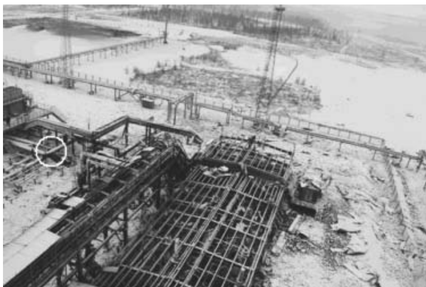
Рис. 1. Вид здания ПЭБ, поврежденного взрывом, с молниеотводной вышки. Кругом обведено место разрушения газопровода
