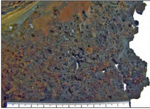
Рис. 5. Вид множественных точечных поражений и раковин на внутренней поверхности фрагмента аварийного участка трубы подающего трубопровода тепловой камеры.
